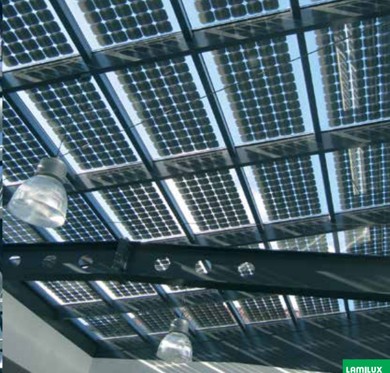
Létesítmény: IBC Solar, Bad Staffelstein
